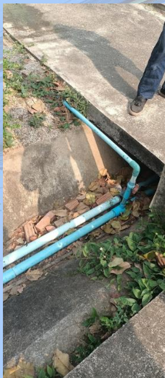
ภาพที่ 1 ระบบน้ำประปา
