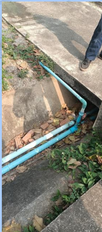
ภาพที่ 1 ระบบน้ำประปา
